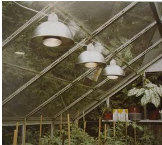
Hình 3.11: Hệ thống đèn chiếu sáng
